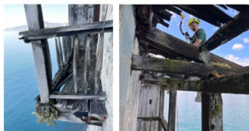
Effondrement partiel du balcon de l'office S3-1 © graf + rouault architectes
